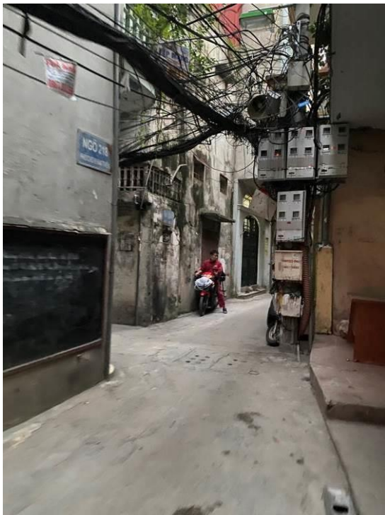
Hình 3.27c: Cột điện và hệ thống đường dây điện kỹ thuật được bó thành từng bó chạy dọc các ngõ
